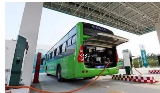
正在给电动大巴充电的直流充电桩
